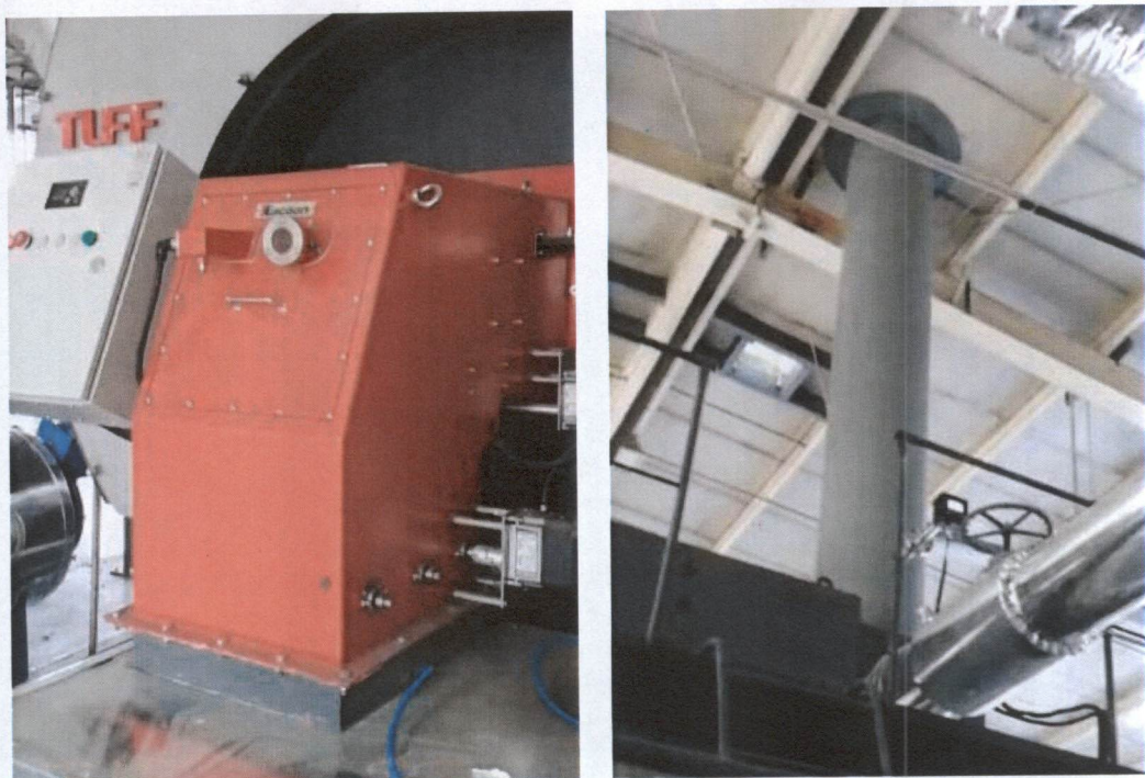
图 4.1-1 超低氮燃烧器及排气筒
